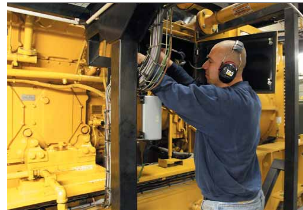
La chaufferie des Glacis, équipée d'un moteur à gaz, produit également de l'électricité.
