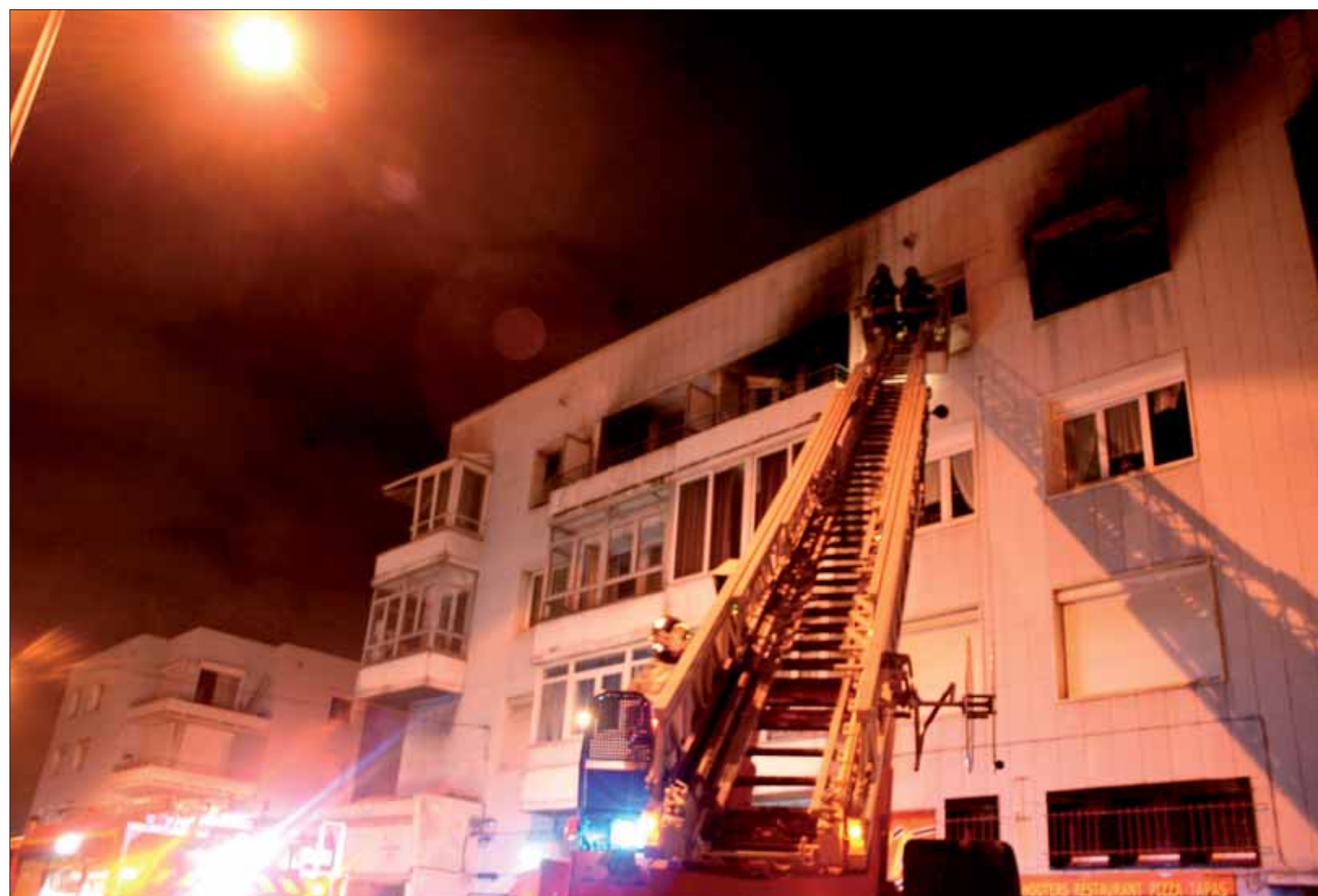
Le troisième étage de l'immeuble a été ravagé par le souffle de l'explosion.
